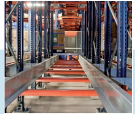
Stockage par accumulation à chariot satellite
